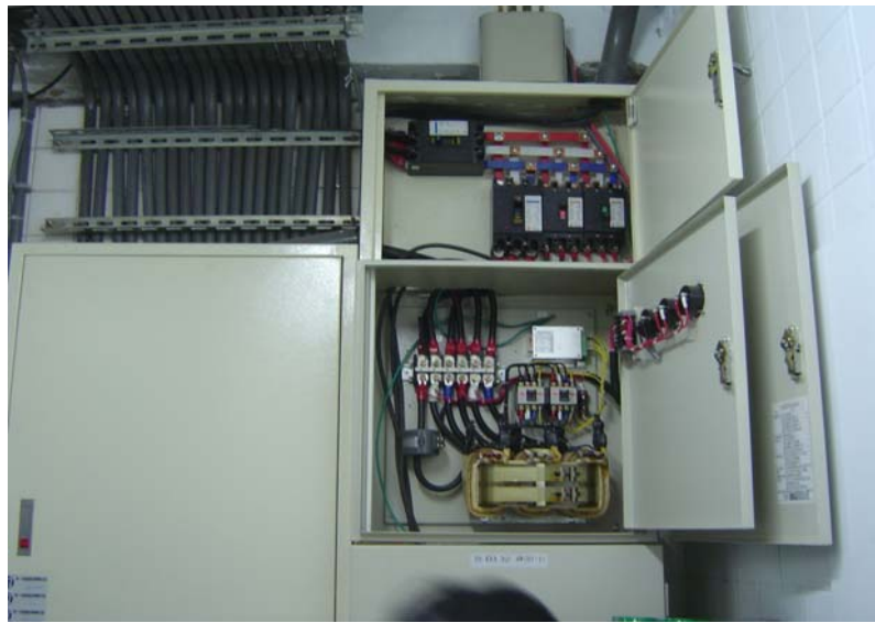
圖 6.3-5 照明節電器安裝實景(便利商店例)
